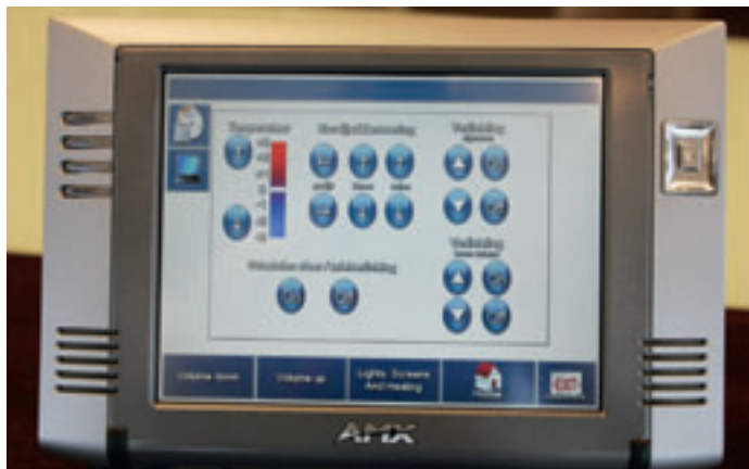
Touchscreen voor de bediening van de audiovisuele en gebouwinstallaties
