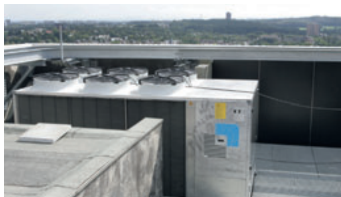
Koelmachine in dakopbouw hoogbouw.
